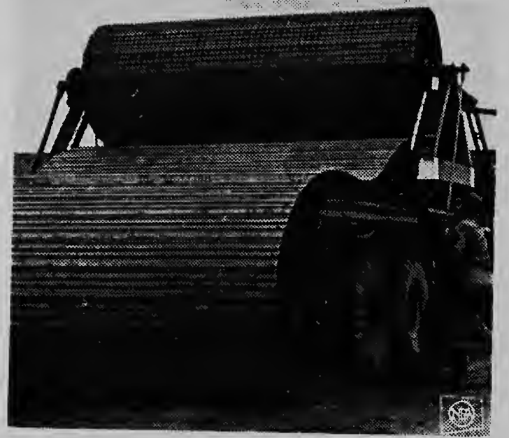
CAMINDA INSTANTE -- Riba e foto aki un caminda flexible di aluminum ta lora for di un cilindro grandi montá patras di un truck di ehercito norteamericano. Despues e ta pasa bao di wielnan di e truck, y presto, caminda ta cla! E proceso nobo aki ta posibel mediante desarollo di stripnan di aluminum di 2 inch dikí qu ta ser assemblá riba roinan di 225 pia. Den futuro por trafico den areanan brutu, pantano y santu cu e sistema aki.
